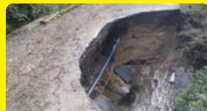
崩落した前山3号線(前山町)
